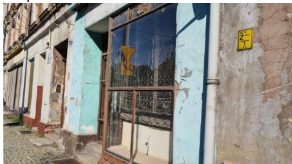
Pustostan przy ul. Kartuskiej, zły stan techniczny budynku
