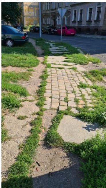
Ulica Łąkowa – zły stan nawierzchni chodnika
