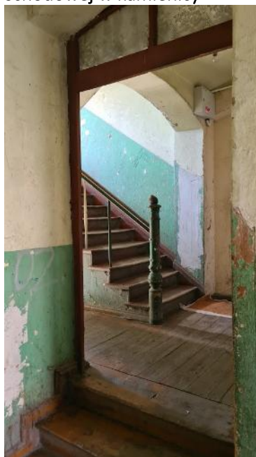
Przykład zniszczonej klatki schodowej w kamienicy
